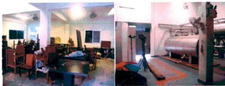
ภาพที่ 3.15 แสดงห้องเครื่องงานระบบ
