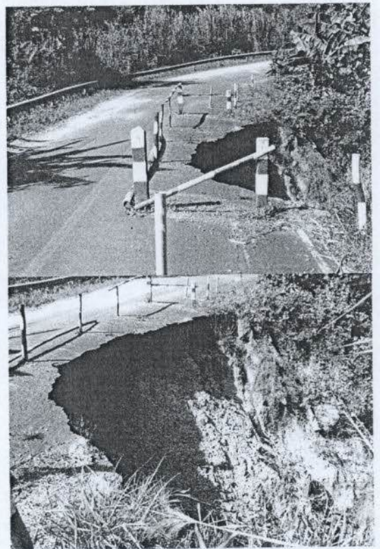
รูปที่ 7 ถนนพังทะลายทางด้านข้าง
