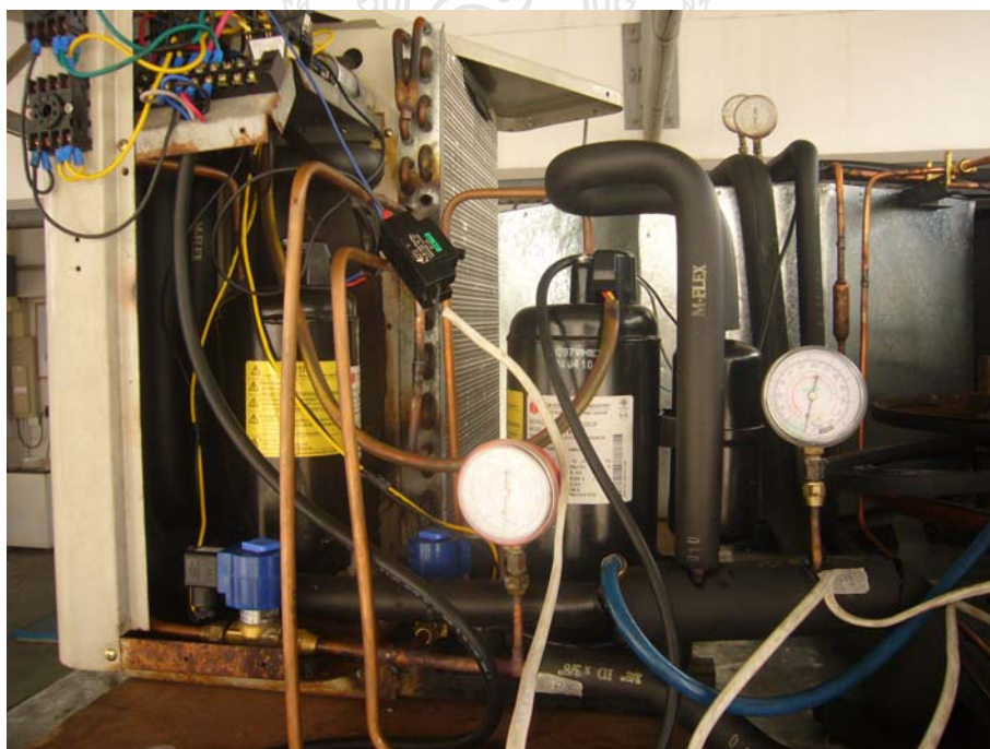
ภาพที่ ก.4 อุปกรณ์และท่อสารทำความเย็นของระบบปรับอากาศ
