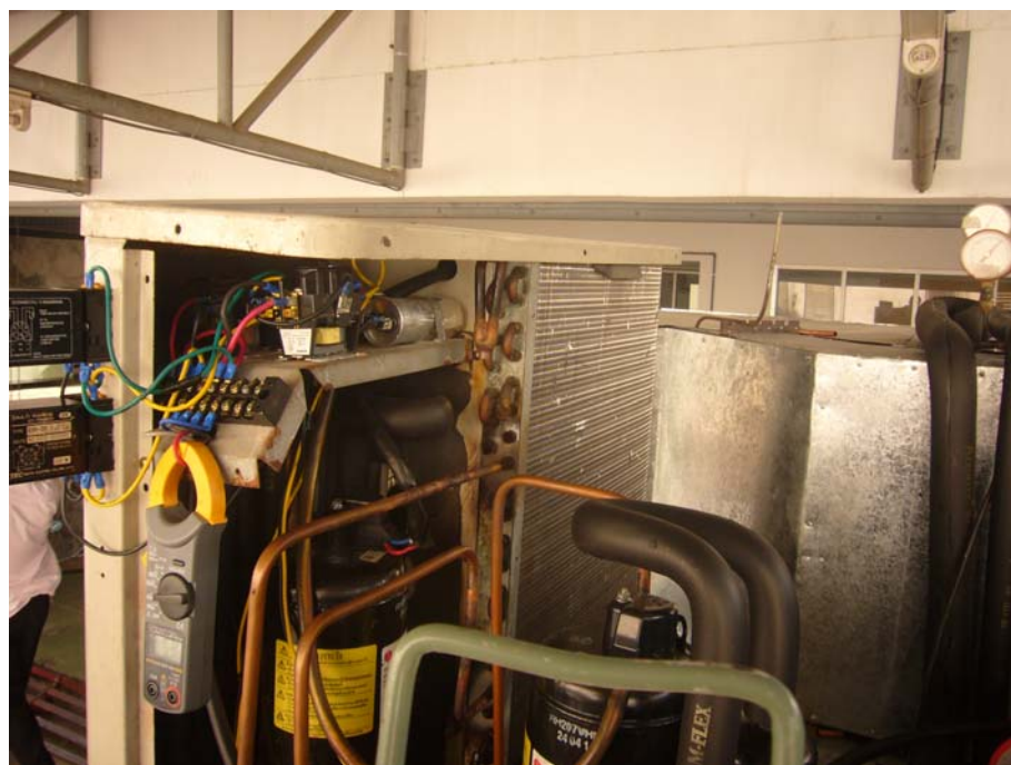
ภาพที่ ก.9 การวัดกระแสและกำลังไฟฟ้าของบิ่มอัดไอ
