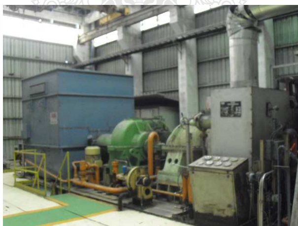
ภาพที่ 3.4 เครื่องกำเนิดของโรงไฟฟ้าที่ 3
