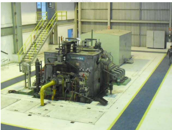
ภาพที่ 3.6 เครื่องกำเนิดของโรงไฟฟ้าที่ 4
