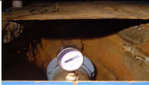
ภาพที่ 53 ความดันน้ำ ที่ Pressure Gauge เมื่อผ่านการทดสอบ ถือว่าระบบท่อพร้อมใช้งาน
