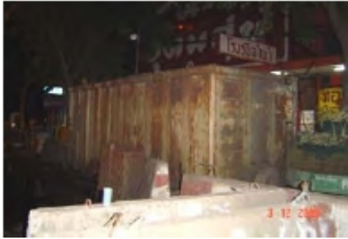
ภาพที่ 19 Muck Tank ต้องมีการทำความสะอาด Tank อยู่เสมอเพื่อไม่ให้เกิดการสะสม ตะกอนดิน
