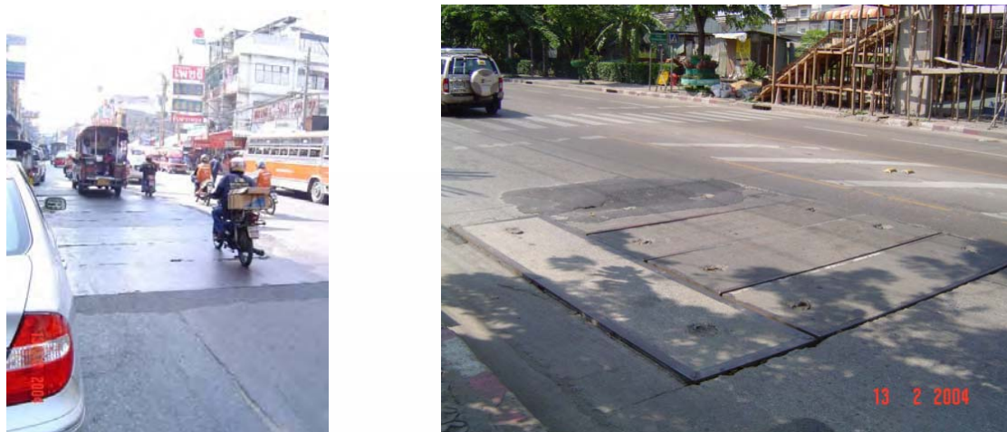
ภาพที่ 2.27 การปิดผิวจราจรด้วยแผ่นเหล็ก (Steel Plate) และแผ่นคอนกรีต (Concrete Deck)
