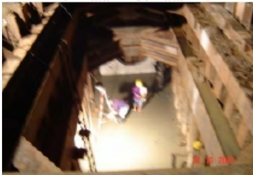
ภาพที่ 5 เท Base Slab เพื่อเป็นฐานรองรับแท่นเครื่องและระบบการดันท่อ
