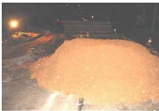
ภาพที่ ๑. จะต้องทำการบดอัดทรายเป็นชั้นๆด้วยความแน่นตามมาตรฐานในขณะที่ถอนSheet Pile และกำลังขุด
