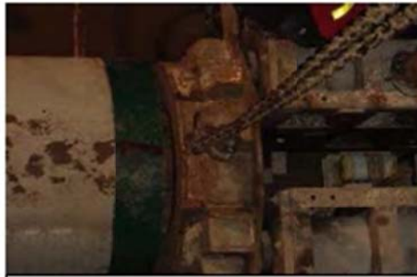
ภาพที่ ๔๗ ติดตั้ง (LIFTING BLOCK) กันระหว่างท่อค้ำ กับชุดแม่แรงแล้วจึงเริ่มการค้ำท่อท่อนแรก
