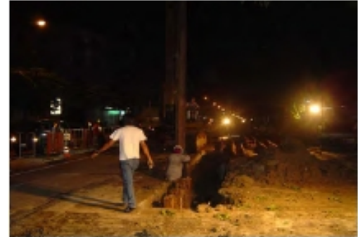
ภาพที่ 3 ทำการกด Sheet Pile เพื่อเป็นการป้องกันดินรอบข้างทรุดตัว
