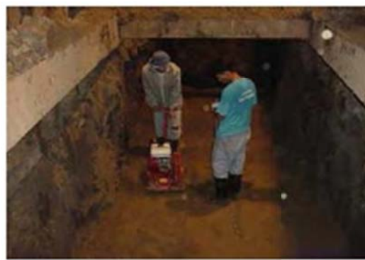
ภาพที่ ๒ แสดงการบดอัดทรายเป็นชั้นๆเพื่อการรื้อถอนบ่อและทำการซ่อมผิวจราจรดาวารคืนตามสภาพเดิมต่อไป
