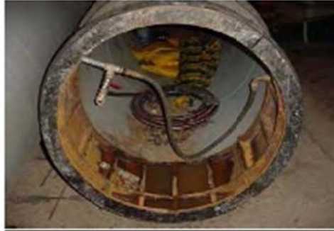
ภาพที่ ๑.๕ แสดงท่อ concrete ที่ติดตั้งเพิ่มเติมเข้าไปในการคืนเพื่อทำการฉีกรละลายโพธิเมอร์ โดยจะมีท่อลักษณะนี้ทุกๆระยะประมาณ ๓-๕ เมตร
