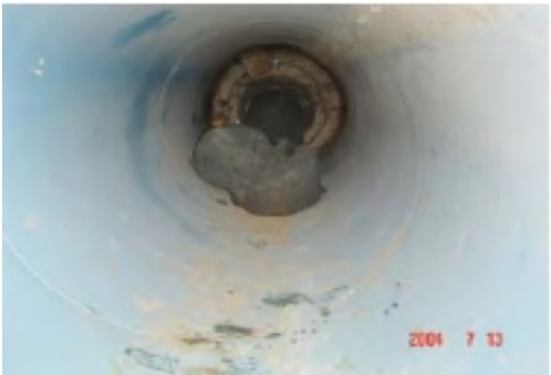
ภาพที่ 46 ภายในท่อเหล็กเหนียวจะเกิดความ สกปรก จะต้องมีกรเช็ดทำความสะอาด
