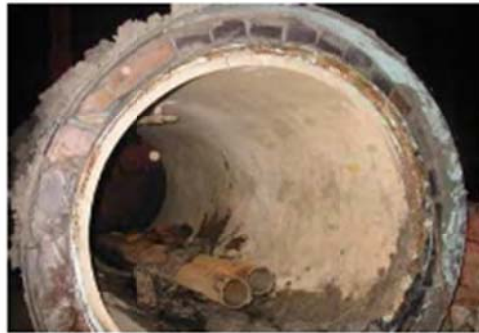
ภาพที่ ๖๗ ทำการรื้อชุดระบบท่อน้ำซึมและ ท่อ น้ำดินออก
