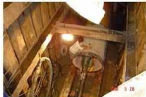
ภาพที่ ๕๐ ทำการติดตั้งระบบท่อผนังชั้นที่ฉีด สารละลายโพลีเมอร์และระบบท่อผนังน้ำค้ำ ออกมาจากหน้าหัวเจาะ
