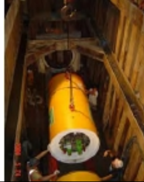
ภาพที่ 20 การติดตั้งชุดหัวเจาะ ภาพที่ 21 การติดตั้งท่อปลอกคอนกรีตท่อนที่ 1 และ 2 เพื่อเตรียมดินพื้นบ่อออกไปพร้อมกับชุดหัวเจาะ
