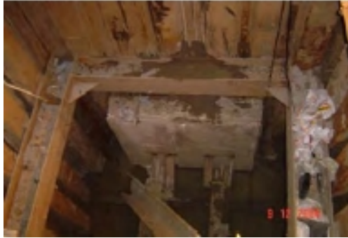
ภาพที่ 7 ติดตั้ง Back Thrust Wall เพื่อให้การถ่ายแรง แผ่กระจายไปยังด้านหลังเป็นพื้นที่รับแรงคีดของแม่ แรง
