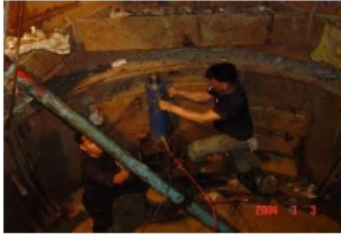
ภาพที่ 55 หากเป็นการถอนบ่อรูปวงกลม จะต้องใช้แม่แรงดีด Segment ขึ้นแล้วทำการ หนุนแล้วจึงถอดออกทีละชั้นส่วน
