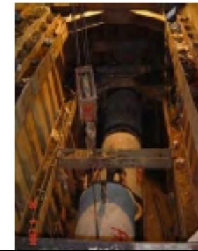
ภาพที่ 21 การติดตั้งท่อปลอกคอนกรีตท่อนที่ 1 และ 2 เพื่อเตรียมดินพื้นบ่อออกไปพร้อมกับชุดหัวเจาะ
