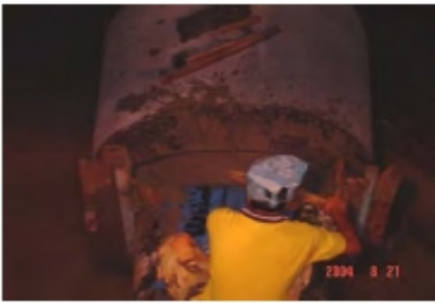
ภาพที่ 51 ทำการ Grout ปิดช่องว่างระหว่างท่อปลอกคอนกรีตกับท่อเหล็กเหนียว
