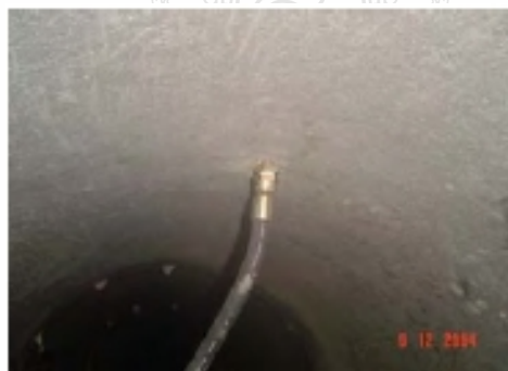
ภาพที่ 29 ท่อคอนกรีตที่ฉีดน้ำเบนโทไนท์ จะมี 3 รอบท่อคอนกรีต
