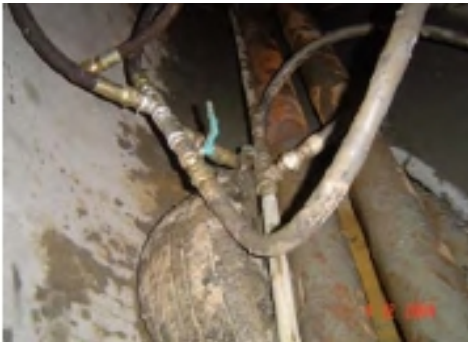
ภาพที่ 28 ทำการติดตั้งสายฉีดน้ำเบนโทไนท์
