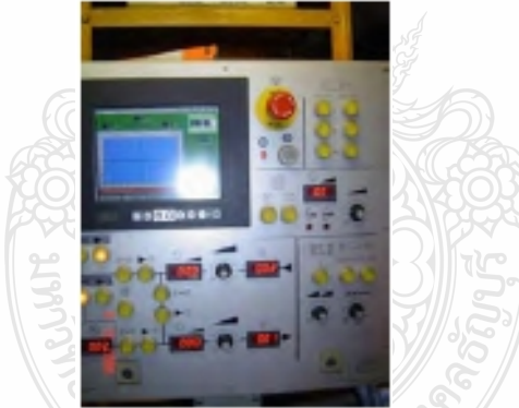
ภาพที่ 17 ภายในตู้ควบคุมจะติดตั้งเครื่องควบคุม การทำงานของหัวคัน ซึ่งจะมีจออมอนิเตอร์แสดง ค่าต่าง ๆ ระหว่างการ
