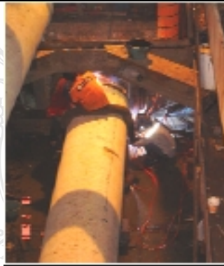
ภาพที่ 41 ทำการติดตั้งท่อเหล็กปากระฆังท่อนต่อไปและทำการเชื่อมทั้งภายใน และภายนอก
