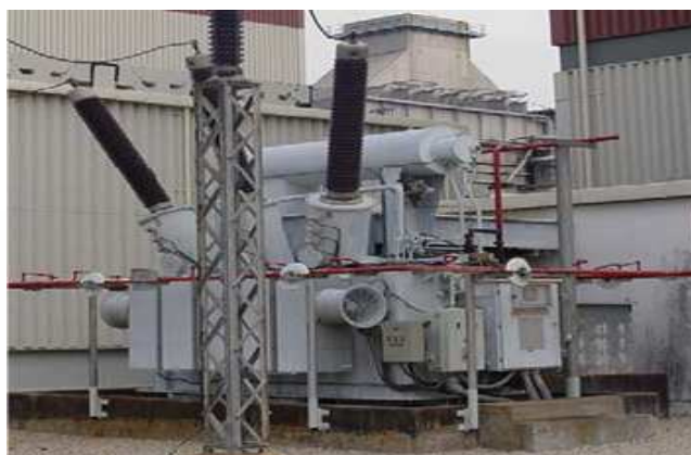
ภาพที่ 3.10 ภาพของหม้อแปลงสำรองจ่ายไฟสำหรับโรงไฟฟ้า
