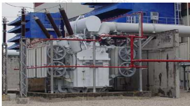
ภาพที่ 3.9 หม้อแปลงสำหรับเครื่องกำเนิดไฟฟ้า
