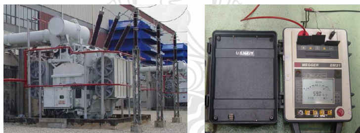
ภาพที่ 4.15 หม้อแปลงไฟฟ้าสำหรับเครื่องกำเนิดไฟฟ้า และเครื่องมือทดสอบ
